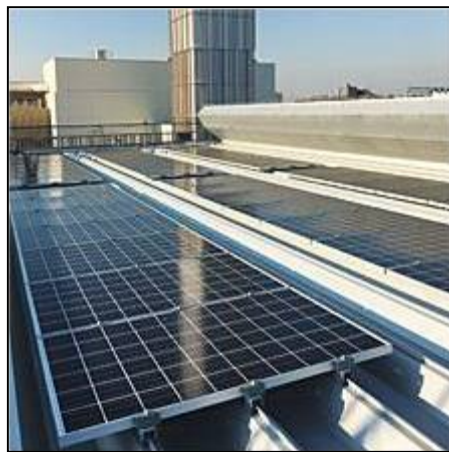
屋上の太陽光パネル（10 kW）
