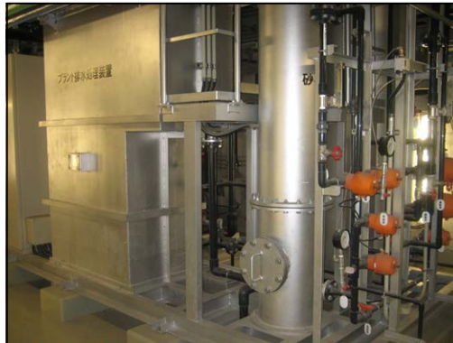
排水処理施設
