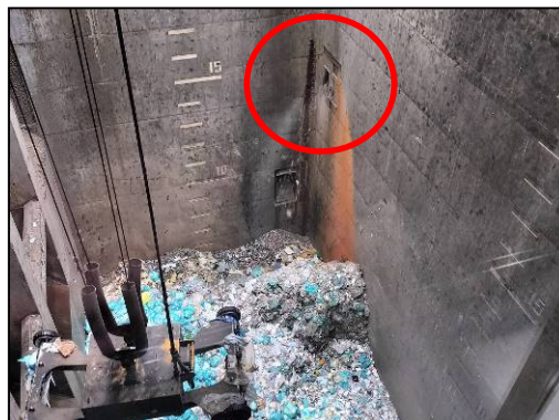
可燃ごみピットの落ち口
