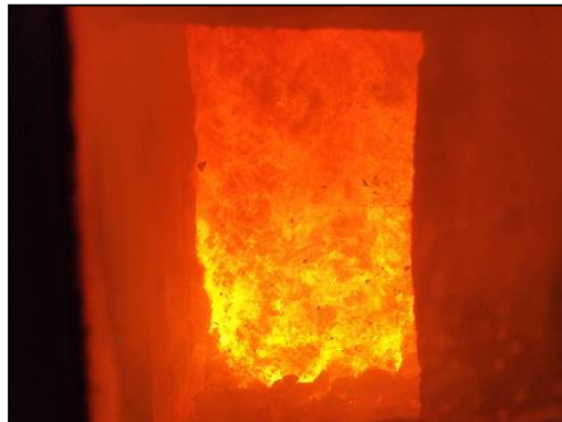
焼却炉内の様子
