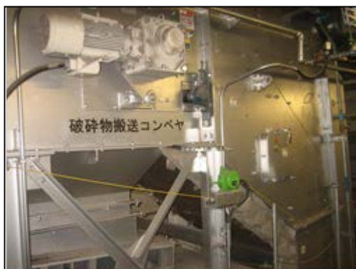
破碎物搬送コンベヤ
