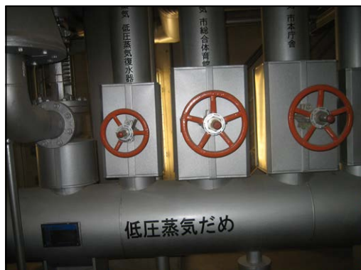
近隣施設への蒸気供給
