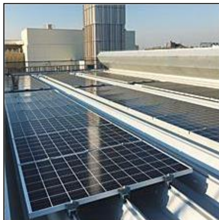
屋上の太陽光パネル（10kw）
