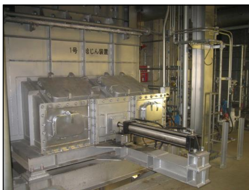
焼却炉へごみを送る給じん装置
