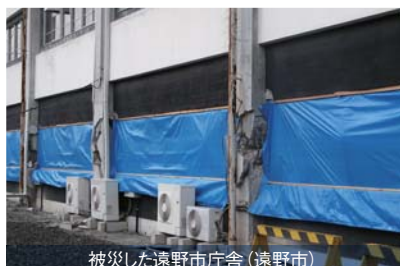
被災した遠野市庁舎（遠野市）
