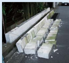
倒壊したブロック塀
