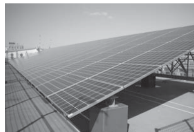
学校屋上の太陽光発電パネル
