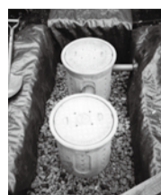
雨水浸透ます
