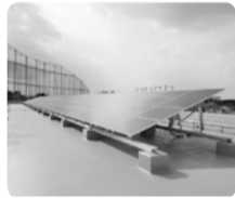
第五中 太陽光発電システム
