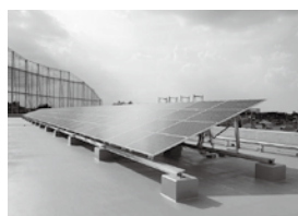
学校屋上の太陽光発電パネル
