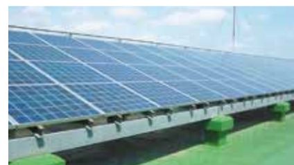
太陽光パネル
