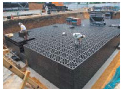
雨水貯留浸透施設
