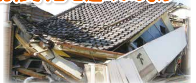
平成19年能登半島地震住家被害の様子(出典:一般財団法人消防科学総合センター)
