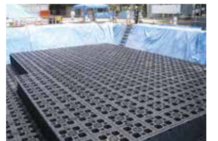
雨水貯留浸透施設
