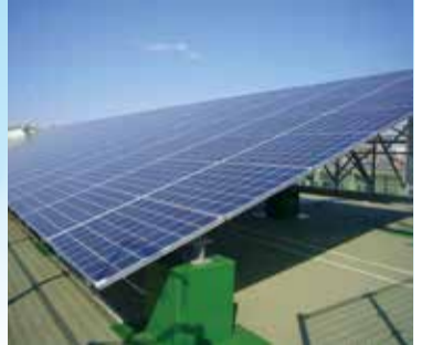
太陽光パネル
