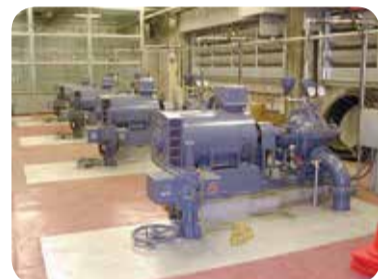
浄水場から水を送り出すポンプ
