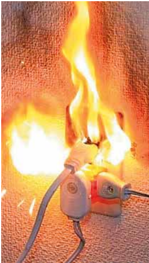
トラッキング火災
