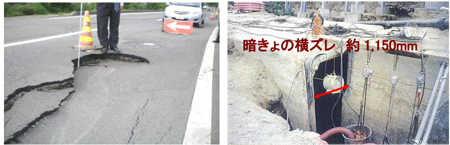
地震による被害事例
