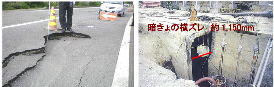
地震による被害事例
