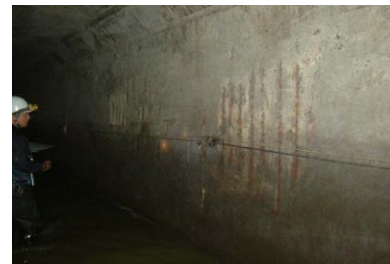
鉄筋が露出する老朽管内の様子
