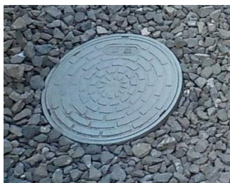
↓宅地内の排水管の点検に使われる「汚水ます」の蓋
