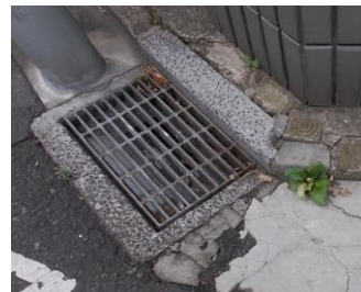
↑道路の雨を下水道管へ流入させるための「雨水ます」
