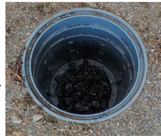
↓雨水浸透ますの蓋を開けたところ。床面や側面の穴から雨水がゆっくり地面に浸透します。
