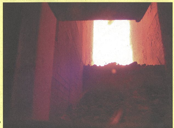
運転開始から25年経過した焼却炉
